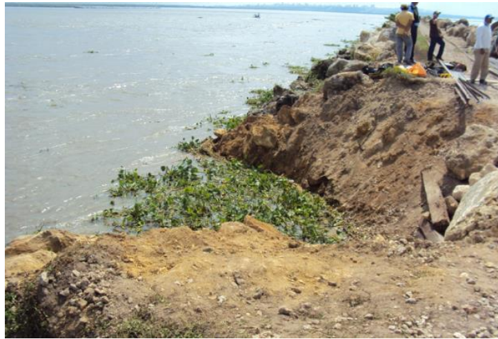
Figura 4. Sitio de impacto del Buque "San Sebastian de Uraba" en el Tajamar Occidental
